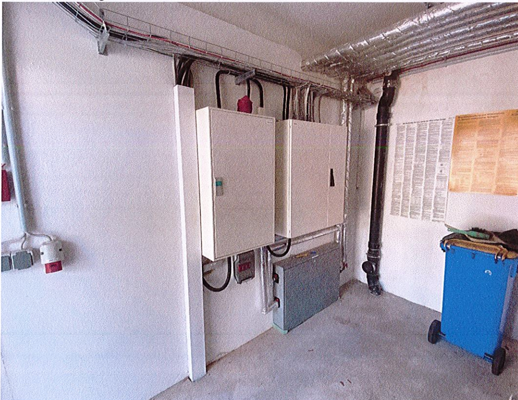
Ansicht ELT-Verteilung im Heizungsraum
