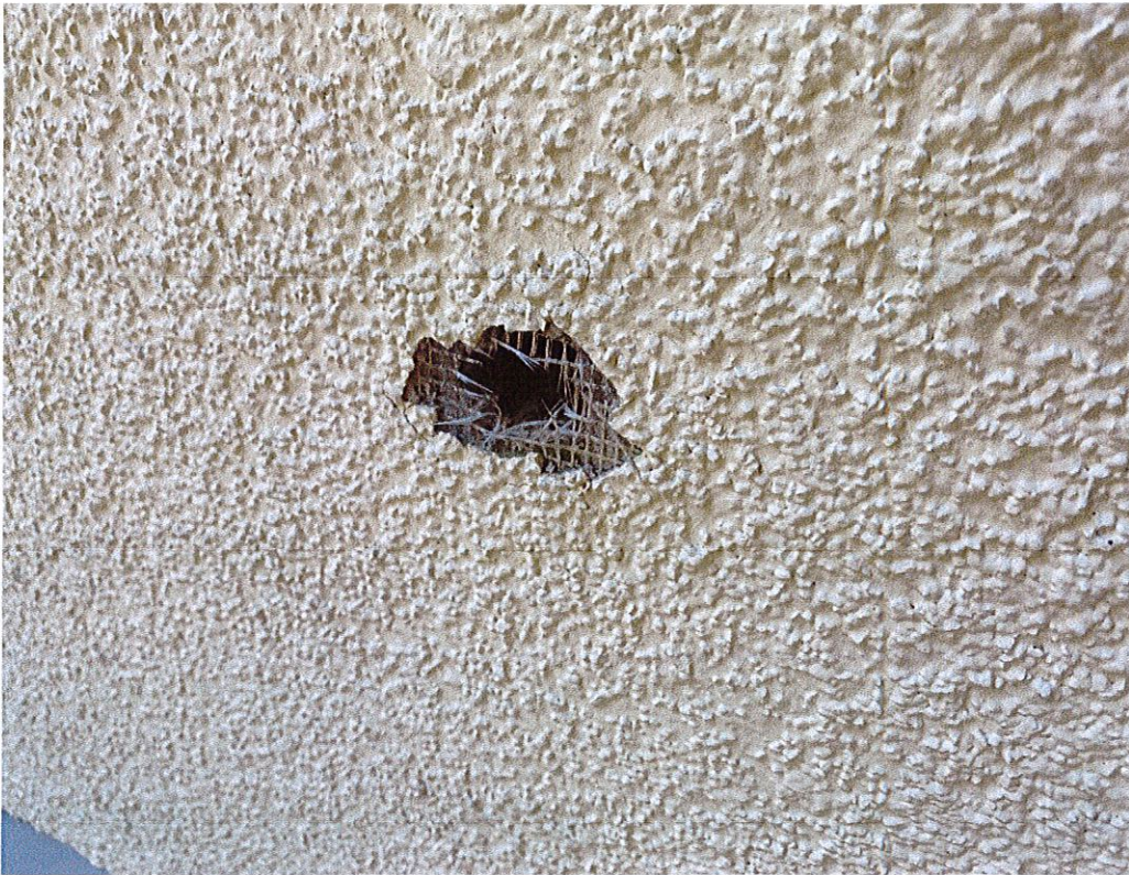
Beispiel eines Baumangels am WDVS-System der Außenfassade
