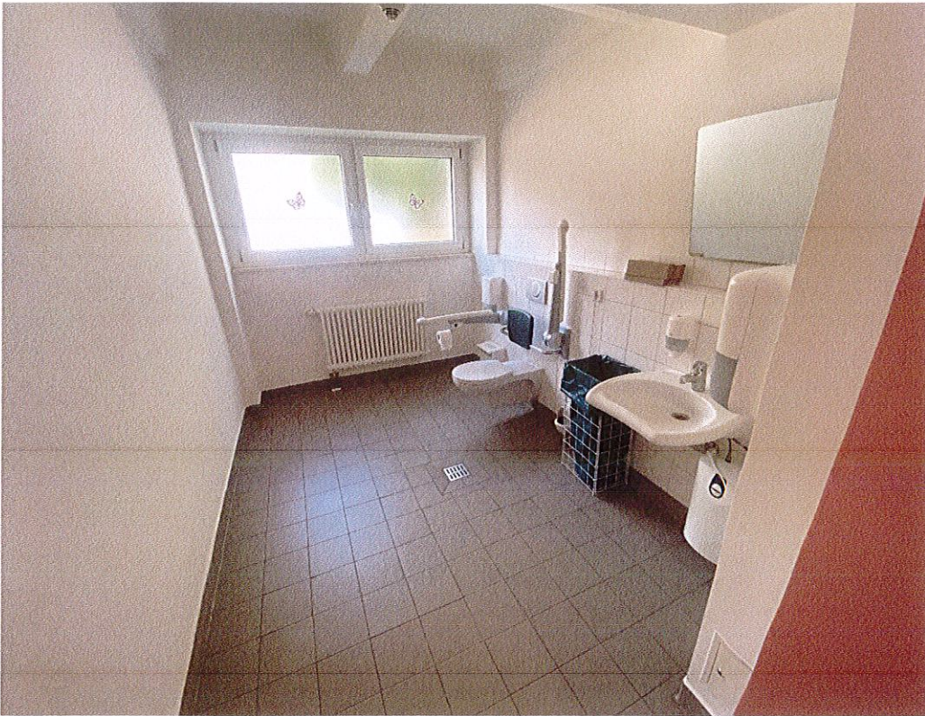
Ansicht WC-Raum des ehemaligen Mieters Jugendring Lausitz
