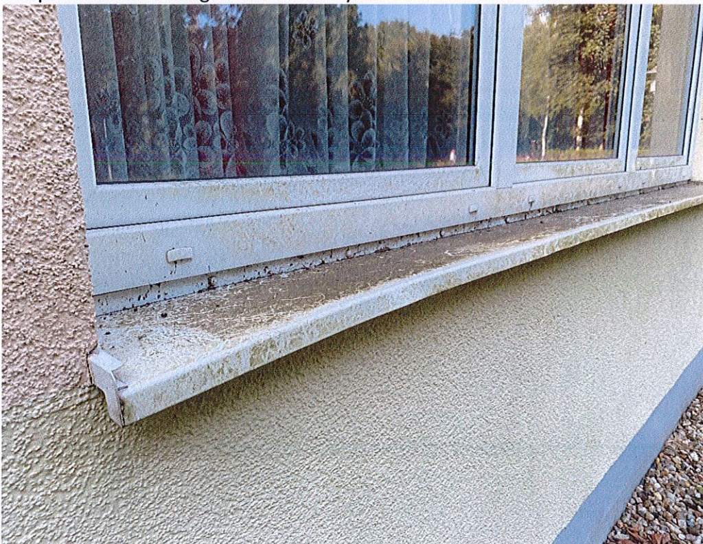
Beispiel abgesunkenes Fensterbrett mit starken Verschmutzungen
